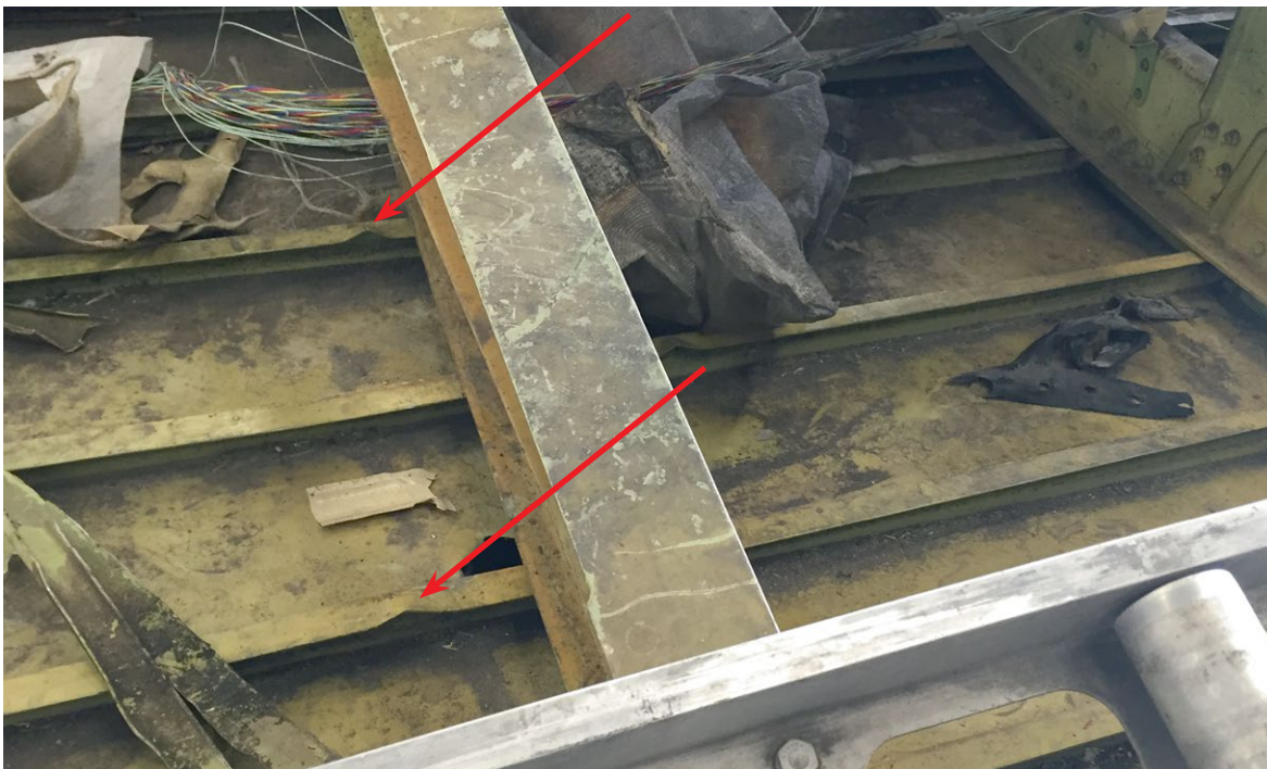
Figuur 22: Illustratie van knikschade aan een langsspan; de rode pijlen geven de compressie aan. (Bron: Onderzoeksraad voor Veiligheid)
